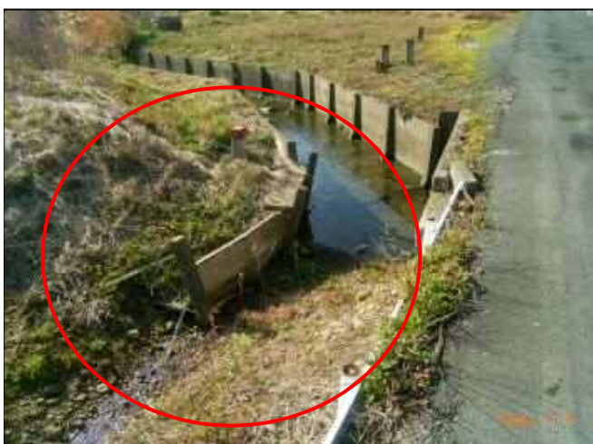
⑤ 排水路が破損している。
