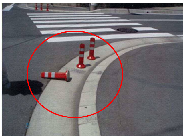
③ 安全施設等が破損している。
