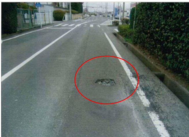
① 舗装に穴があいている。
