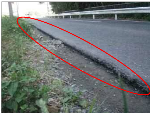
② 路肩が欠落し危険である。
