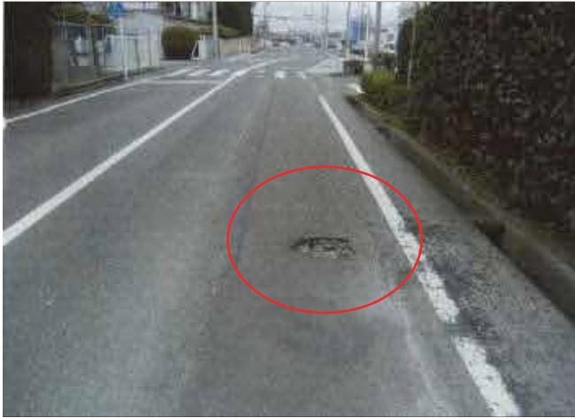
① 舗装に穴があいている。
