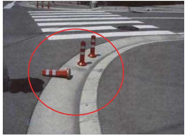
② 安全施設等が破損している。
