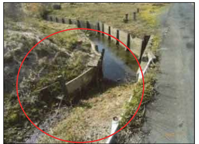
④ 排水路が破損している。
