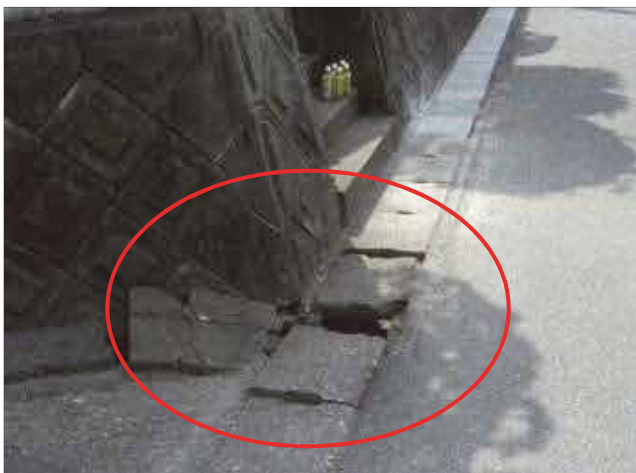
③ 側溝の本体や蓋板が破損している
