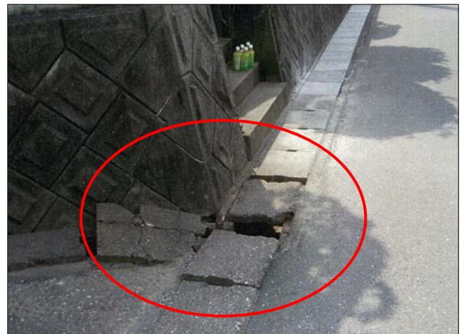
④ 側溝の本体や蓋板が破損している。
