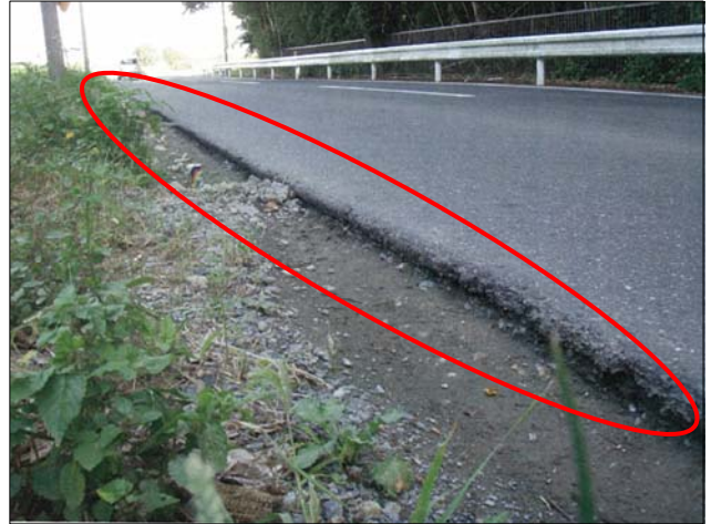
② 路肩が欠落し危険である。
