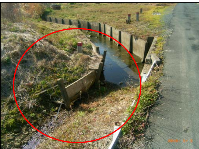
⑤ 排水路が破損している。
