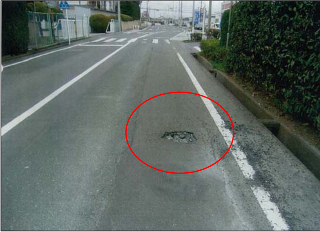
① 舗装に穴があいている。
